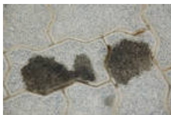
Ölfleck auf Pflasterstein
